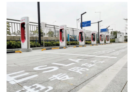
园区新能源汽车充电设备
